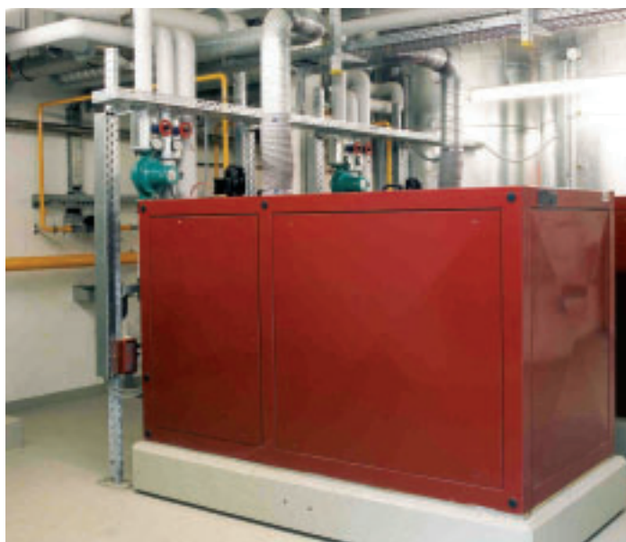
Blockheizkraftwerk, Quelle: KliBA
